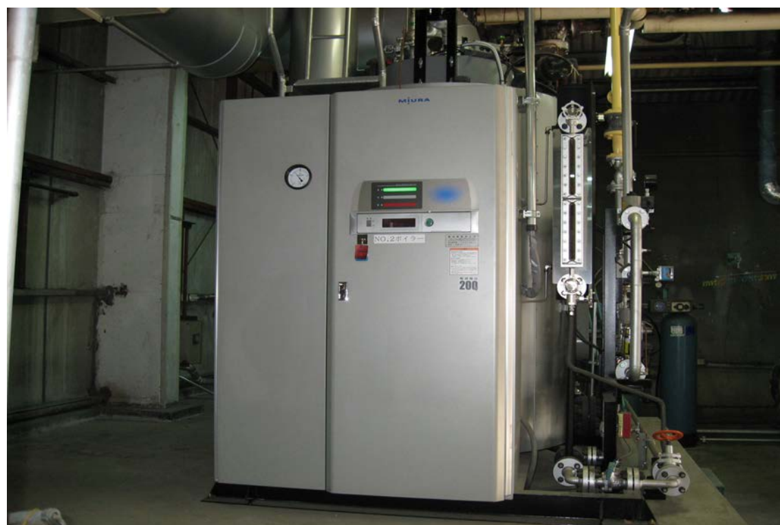
2010年12月導入 高効率のガス焚きボイラー
