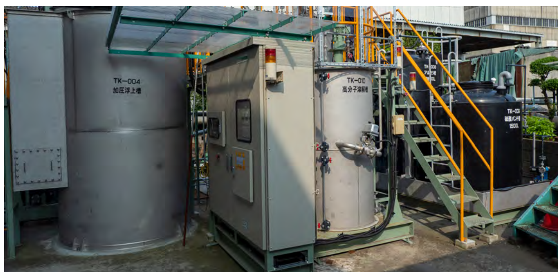
2018年9月導入 最新型加圧凝集浮上設備
