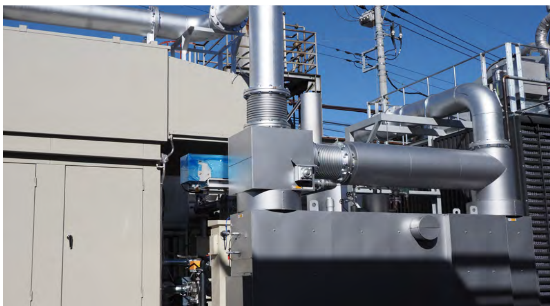
2019年3月導入 ガスコージェネレーション
