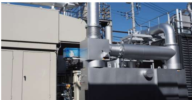
2019年3月導入 ガスコージェネレーション
